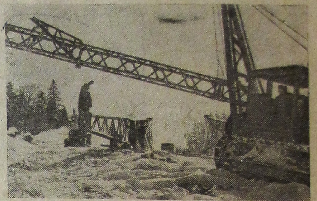
ПРИМОРСКИЙ КРАЙ. Через тайгу, хребты Сихотэ-Алиня и горные реки прокладывают линию электропередачи монтажники Приморского участка управления «Дальэнергомонтаж». Новая линия рассчитана для передачи тока напряжением 220 тысяч вольт на расстоянии 355 километров от Сучанской ГРЭС до поселка Горелое Тетюхинского района. Она будет питать электроэнергией полиметаллический комбинат «Сихали» и Хрустальненский горнообогатительный комбинат.
